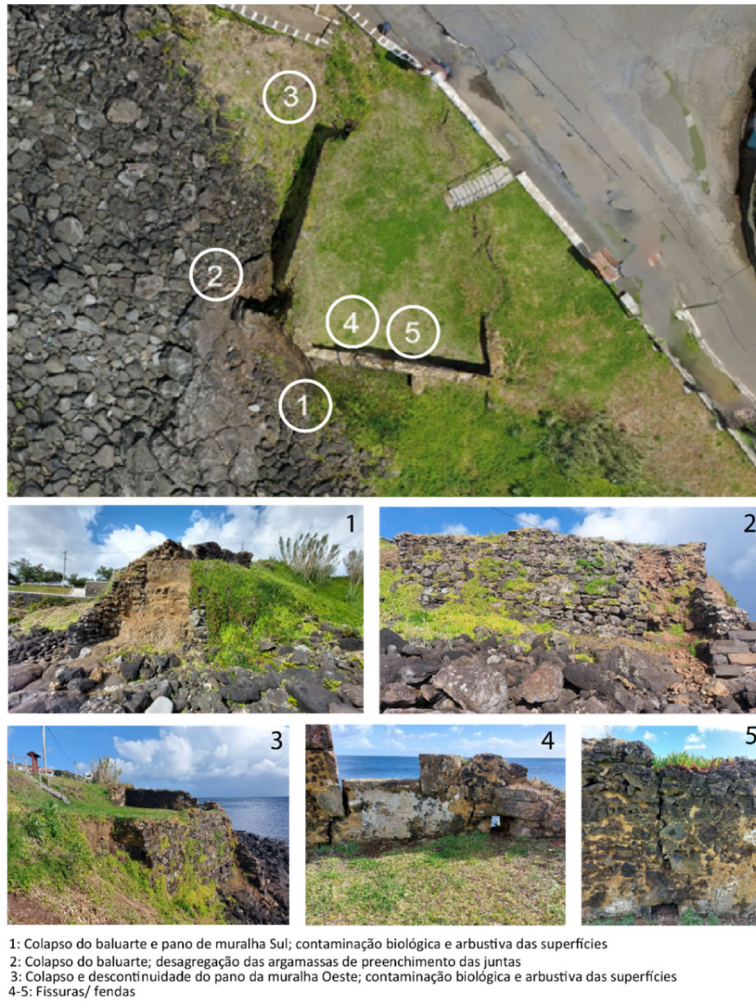
Fig. 1: Mapeamento sumário de patologias
